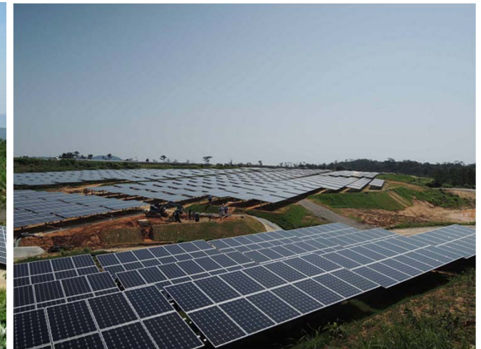
いちご名護二見ECO発電所 (沖縄県名護市)
