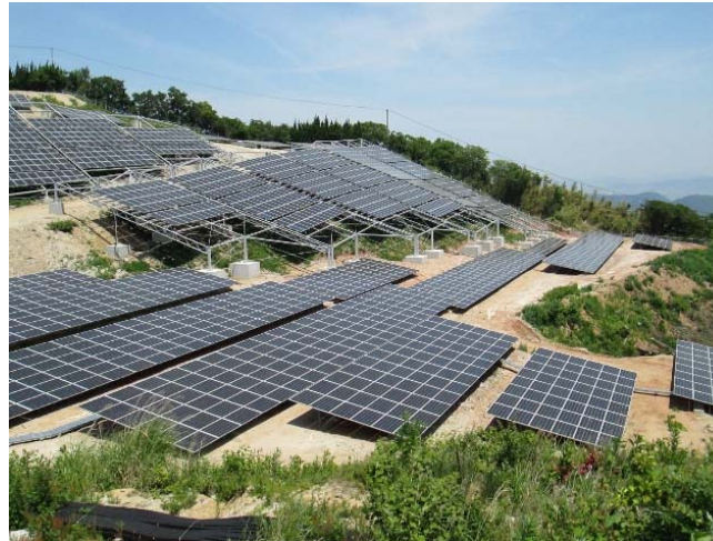
いちご高松国分寺町新居ECO発電所 (香川県高松市)
