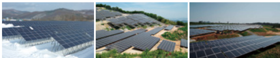
いちご遠軽東町ECO発電所 (北海道紋別郡) いちご高松国分寺町新居ECO発電所 (香川県高松市) いちご名護二見ECO発電所 (沖縄県名護市)
