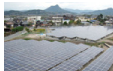
いちご山口秋穂西ECO発電所(1.24MW)
