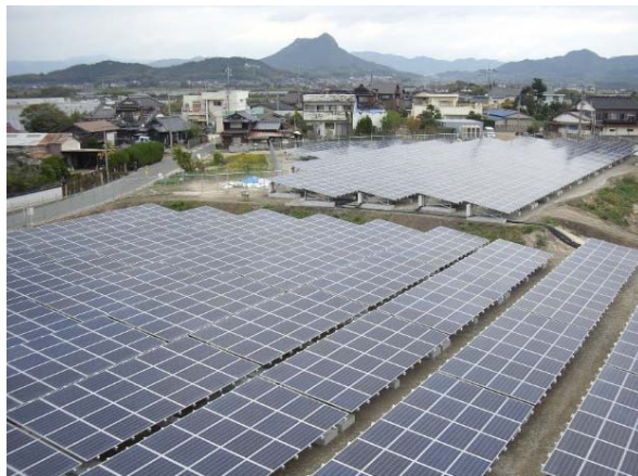
いちご山口秋穂西ECO発電所(1.24MW)
