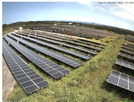
WEBカメラによる発電所の様子
