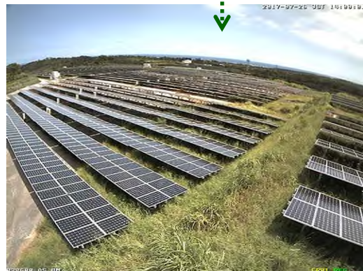
WEBカメラによる発電所の様子
