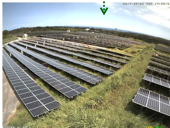
WEBカメラによる発電所の様子
