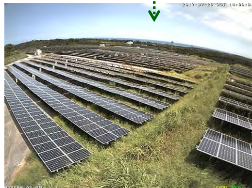
WEBカメラによる発電所の様子
